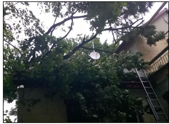
Drzewo przewrócone na budynek mieszkalny – 08.07.2015r.
